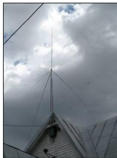
Fig. 2. Instalație de protecție împotriva orajelor
